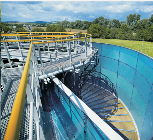
СТАНЦИИ ОЧИСТКИ СТОЧНЫХ ВОД
